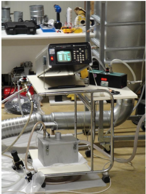
Partikelmätningar (DEHS) före och efter filter F7
